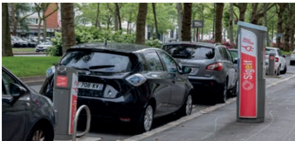
Bornes de recharge des véhicules électriques
