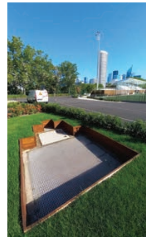
Regard technique de la cuvette de récupération des eaux pluviales sur l'île de Puteaux
