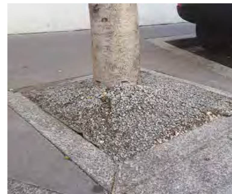
Pied d'arbre imperméabilisé affectant son développement
