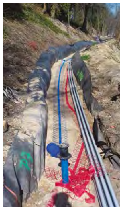
Réseaux sous voirie sous les berges de Seine
