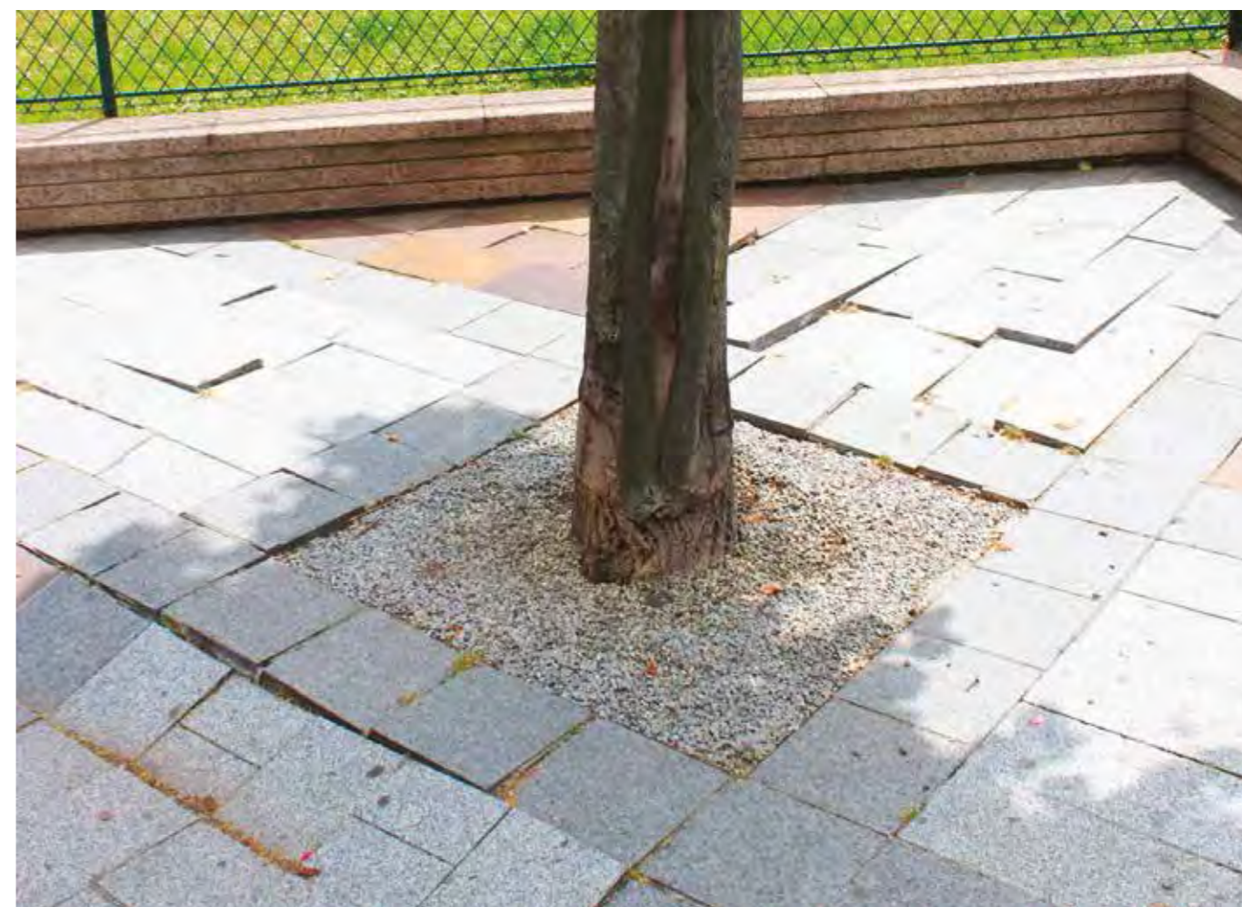
Destruction d'un revêtement par des racines
