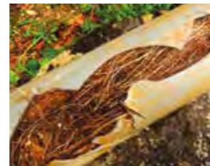
Racines d'arbres s'infiltrant dans un réseau
