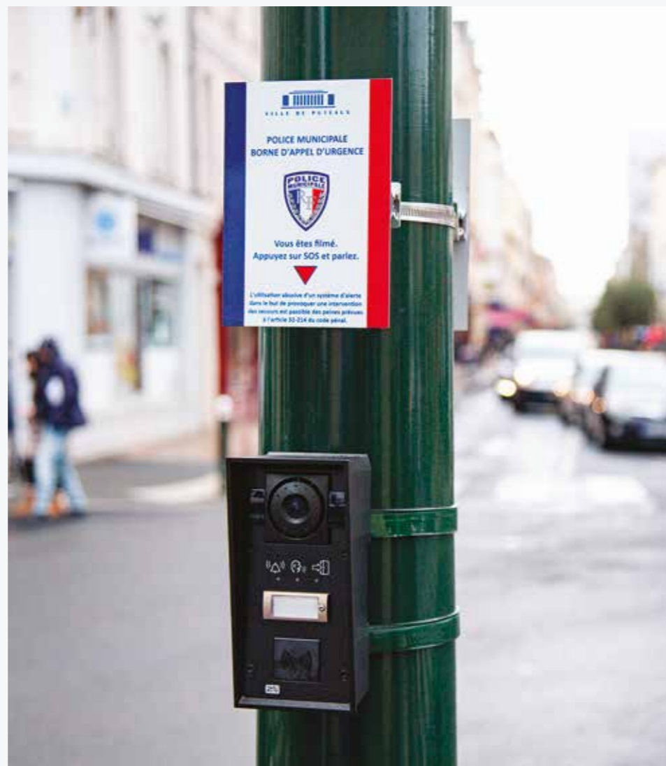
Borne d'appel d'urgence - Angle rue Jean Jaurès et rue Anatole France
